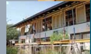
Die richtige Höhe ist erreicht. Die neuen Wände werden in Holzständerbauweise montiert.
