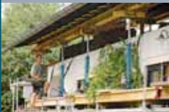
Ready for Take off: Das Dach hebt langsam ab und schwebt über den Mauern des Erdgeschosses.
